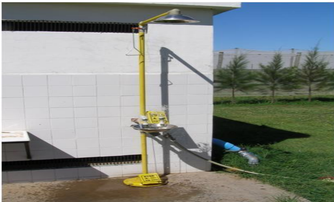
Ducha y lavaojos ubicado a la salida del almacén de agroquímicos. Es importante observar las rejillas instaladas para favorecer la ventilación natural.
