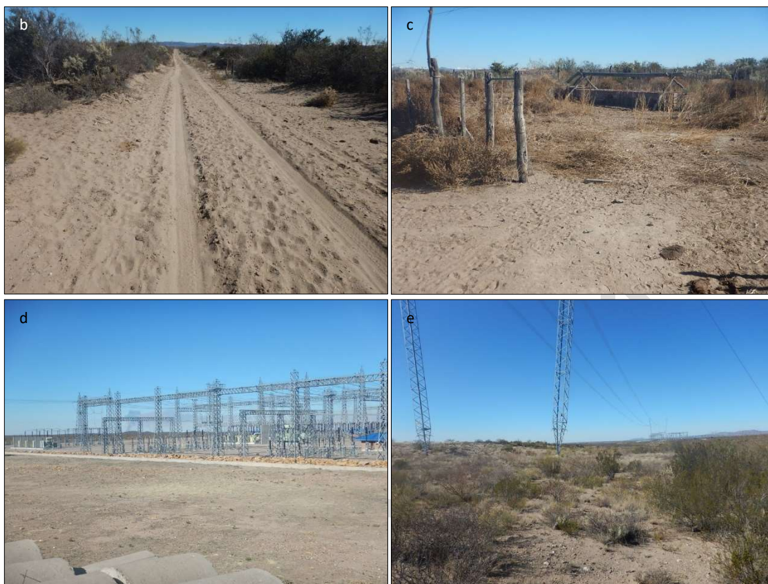
Fotos 2 a-b-c-d-e. Caminería (a-b), alambrados (c), ET Río Diamante (d) y LEAT 500 kV (e).
