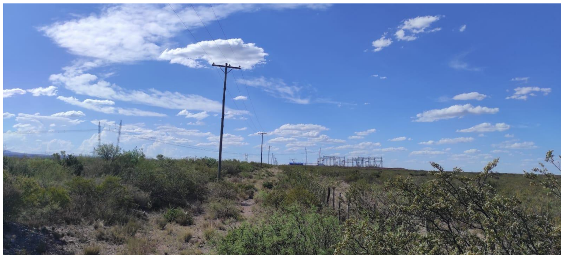
Foto 2: Vista de la infraestructura eléctrica cercana (dos LAT y ET).
